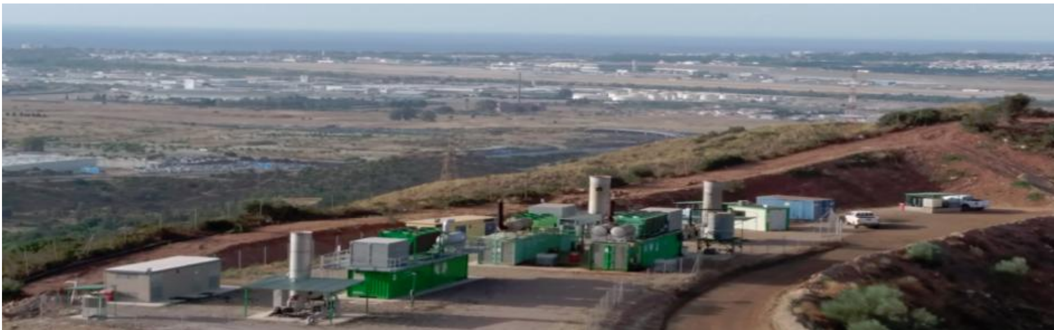
Planta de Desgasificación y Generación Eléctrica
