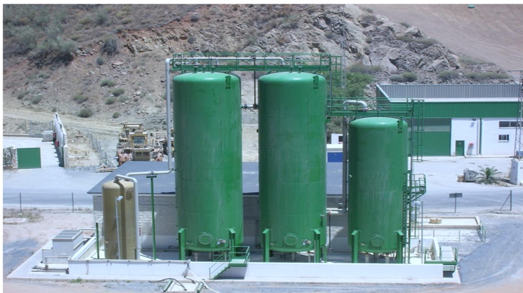
Planta de tratamiento de Lixiviados del CAM
